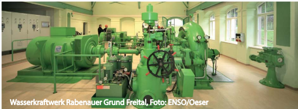
Wasserkraftwerk Rabenauer Grund Freital, Foto: ENSO/Oeser
